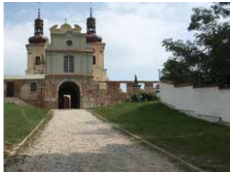
fot. 3. Klasztor w Bieniszewie w remoncie, budynek bramny - stan z sierpnia 2018 r. [fot. archiwum autorki]
